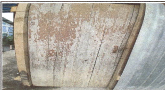
FOTO 3: PUERTA: Sustitucion de madera por metal
